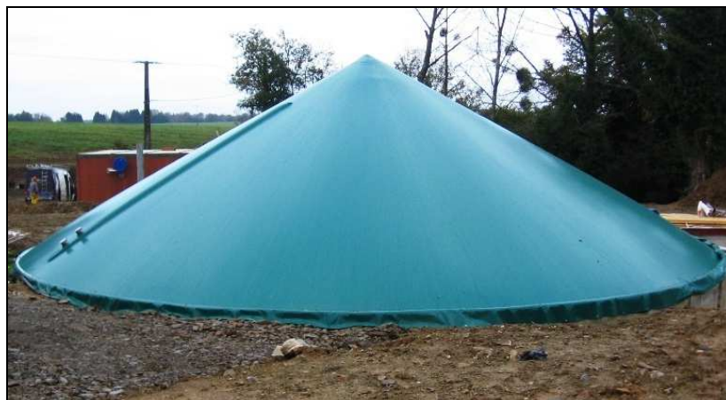
Exemple de gazomètre double membrane
