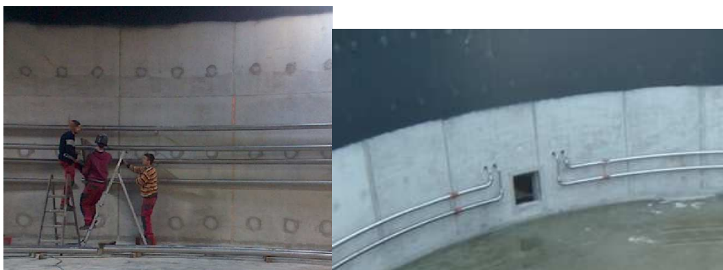
Réseau de chauffage du digesteur et du post-digesteur
