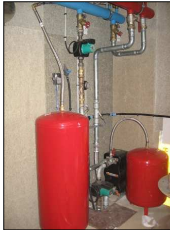
Gestion des réseaux de chaleur
